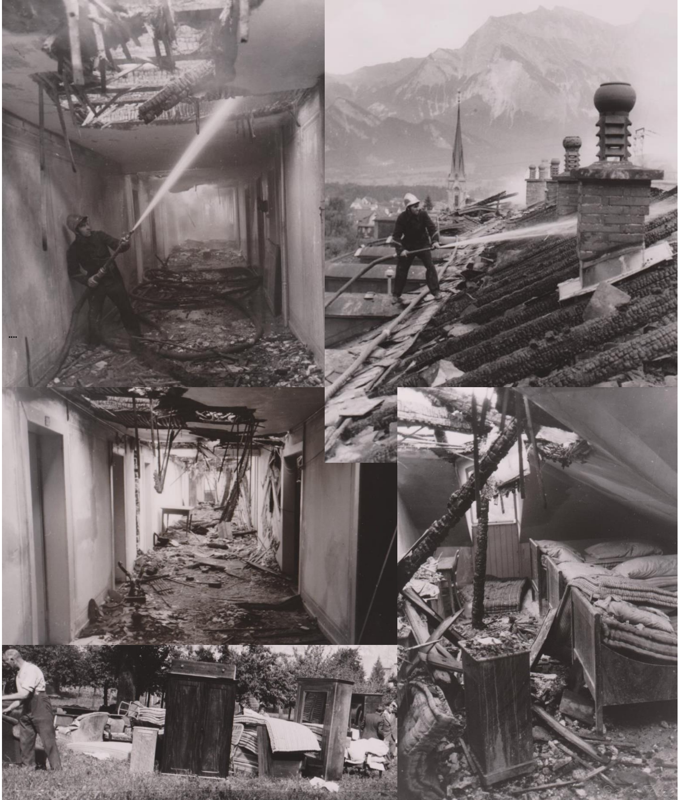
Die Schäden am Gebäude und Inventar. (Quelle: Ivo Widrig)
