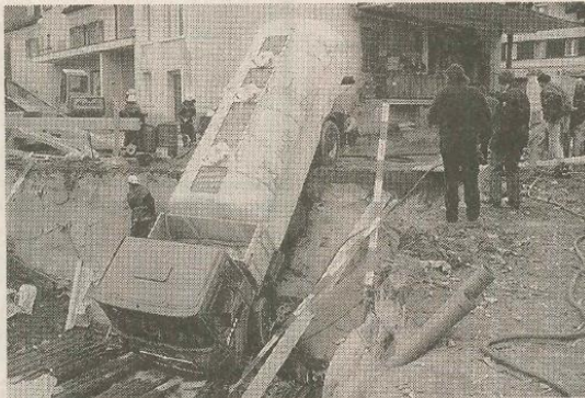
Stürzte selbständig und führerlos in die sieben Meter tiefe Baugrube des geplanten Coop-Centers in Bad Ragaz: ein Milch-Tanklastwagen der Firma Hunger, Jenins. (Bild Theo Gstöhl)
