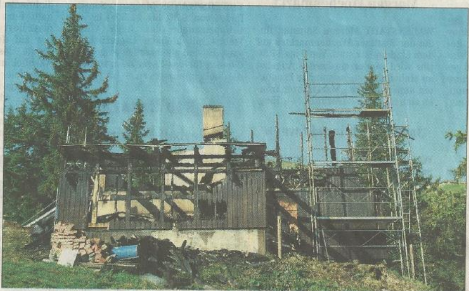
Vollständig zerstört: Das Ferienhaus zeigt sich gestern am frühen Morgen als Brandruine.
